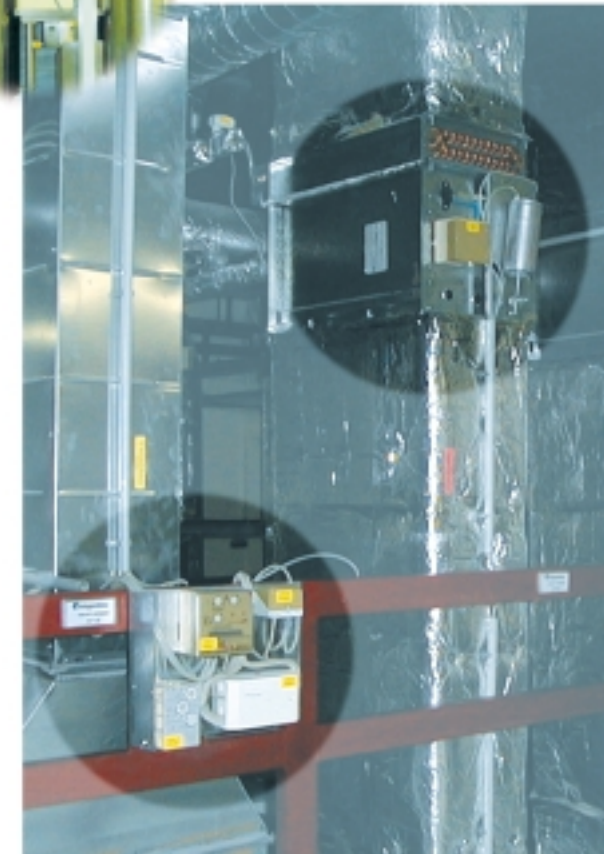
Ansicht einer Luftver-/entsorgungsgruppe für eine Rein-Raum-Zone. Pneumatisch-elektronische Regler und Wandler sind auf einem Panel zusammengefasst und sowohl über elektrische wie auch über pneumatische Leitungen mit den übrigen Mess- und Steuerorganen verbunden.
